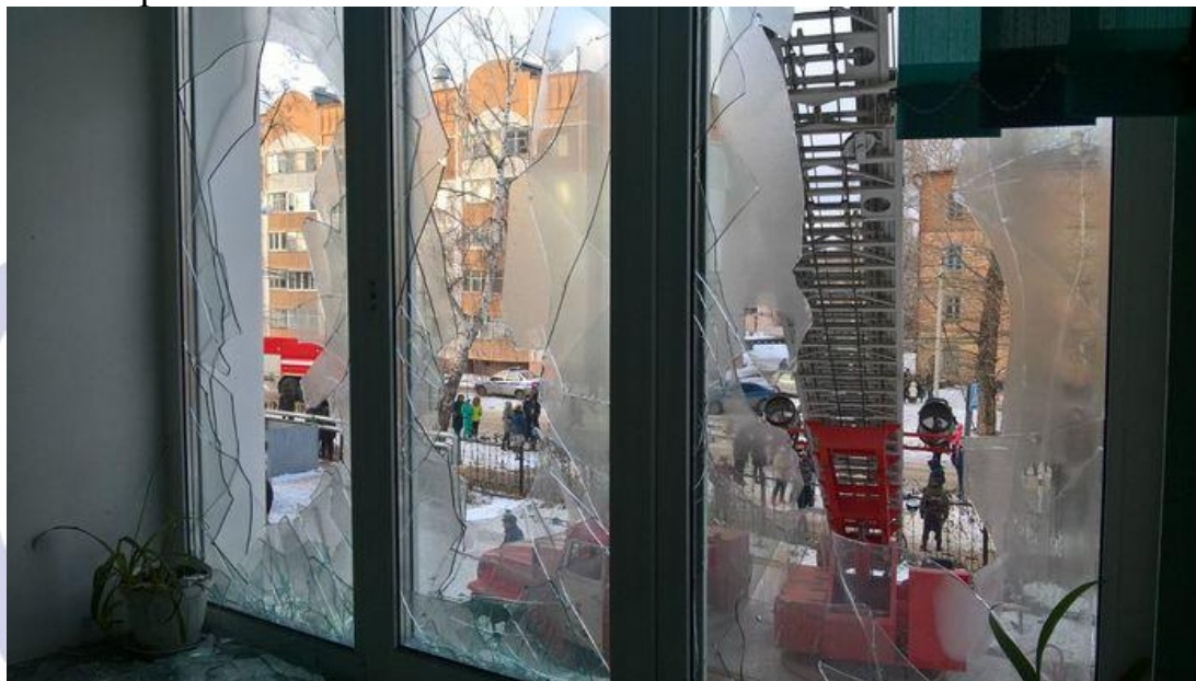
Рис.4. Последствия пожара в школе №32 г. Казань.
