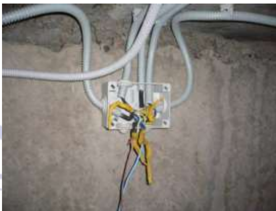
Рис. 1. Нарушение целостности изоляции электропроводов.
